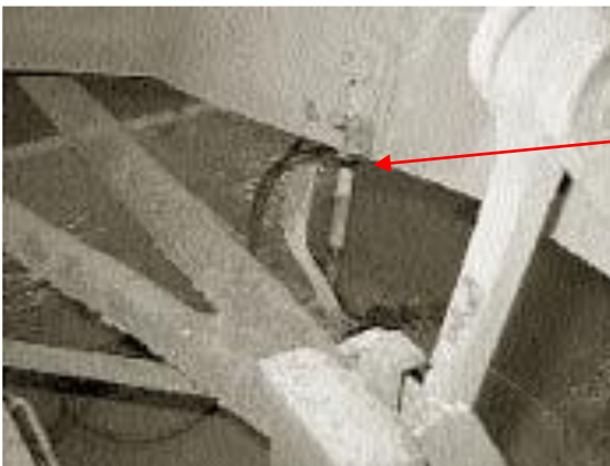
Slika 2 Zlomljena lovilna obesa zavornega trikota
